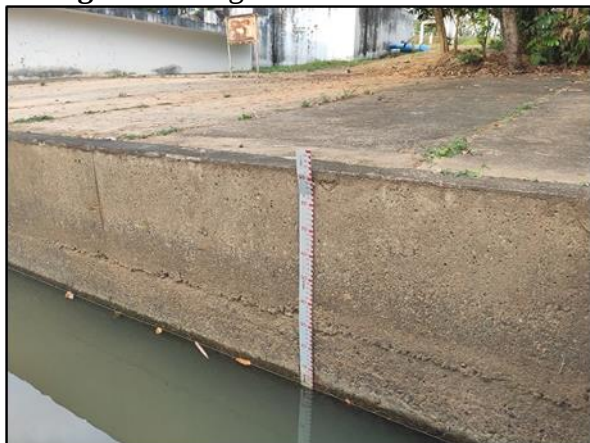
Figura 4 - Régua linimétrica instalada
