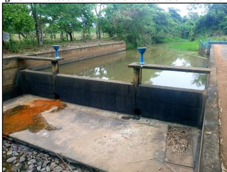
Figura 7 - Vertedor sem vazão remanescente em 23/10/2017.
