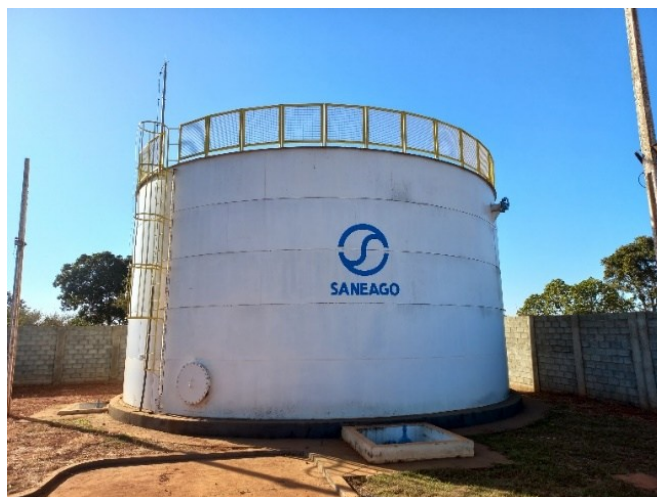
Figura 15 – Reservatório de abastecimento de água potável construído para servir ao loteamento Nova Iporá
